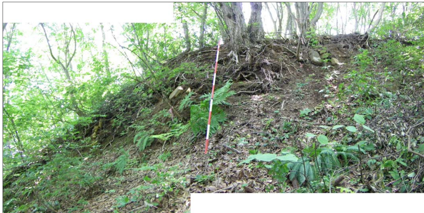
⑱ \Phi 0.5\text{m} 大の安山岩の岩塊を混入した露頭。基質は砂・礫混じりの粘性土で軟質である。
