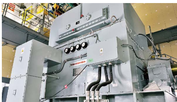
蒸気タービン発電機
